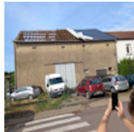
Toiture envolée à Lelling (57) le 16 juillet
